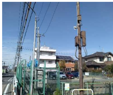
既設ポール取付カメラ②
